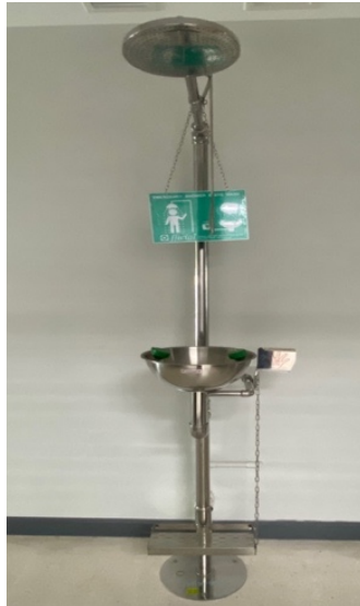
ภาพที่ 3.21 ฝักบัวและอ่างล้างตาฉุกเฉิน (Emergency Shower)
